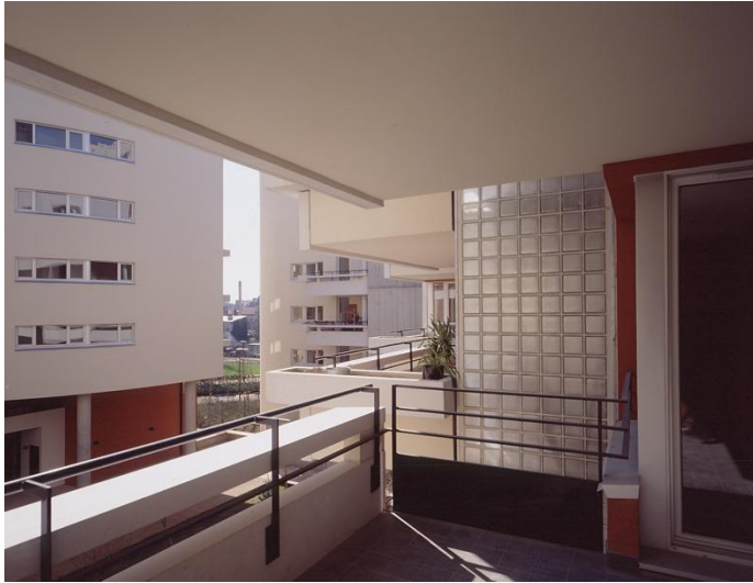
Fig. 5 À gauche, vue de la faille depuis un balcon-terrasse au moment de la livraison © Hervé Abadie
