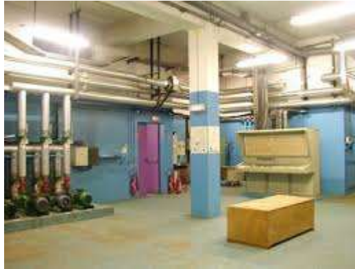
007 – Géothermie - la Centrale
